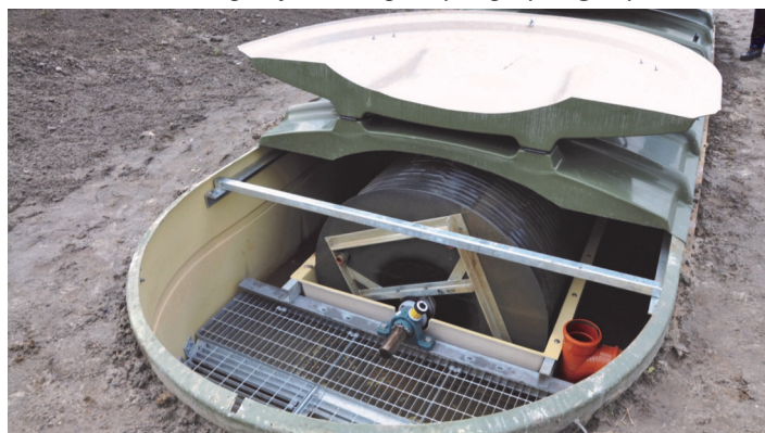
Poprawiająca komfort życia mieszkańców lokalna oczyszczalnia ścieków w Półku
